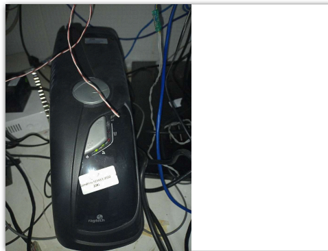
Nobreak - Patrimônio: 2095 - Recepção Centro d...
