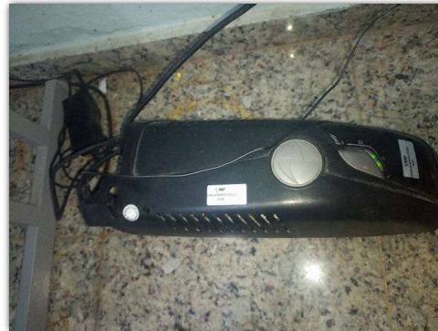
Nobreak - Patrimônio 2102 - Setor da Assistênci...
