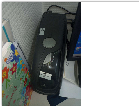
Nobreak - Patrimônio: 2089- Sala de laudo.
