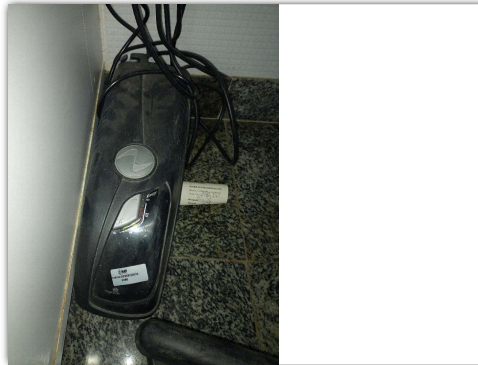
Nobreak - Patrimônio: 2088 - Recepção Centro d...
