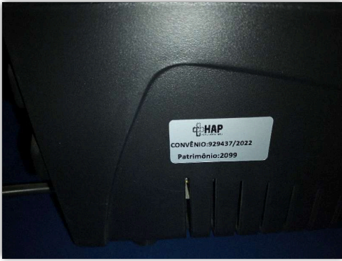
Nobreak - Patrimônio: 2099 - Pronto Socorro
