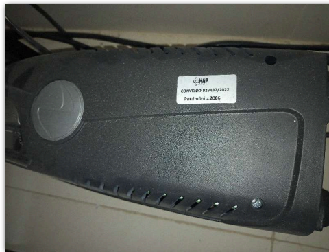
Nobreak - Faturamento - Patrimônio 2086
