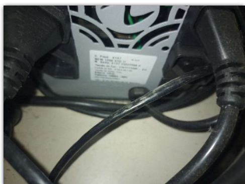
Nobreak - Faturamento - Patrimônio 2087
